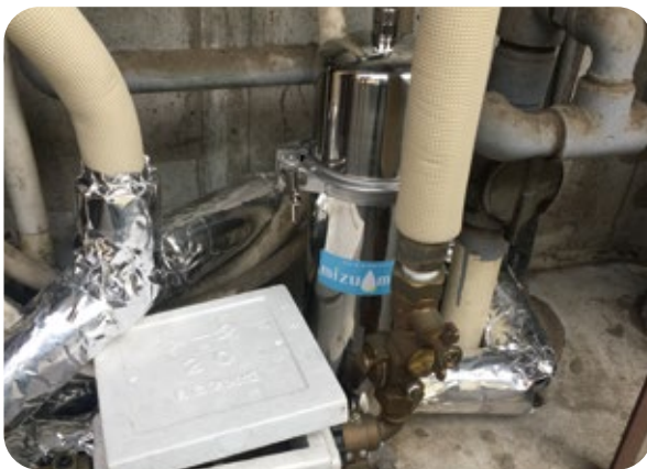
マンション、玄関横のパイプスペース内へ設置
